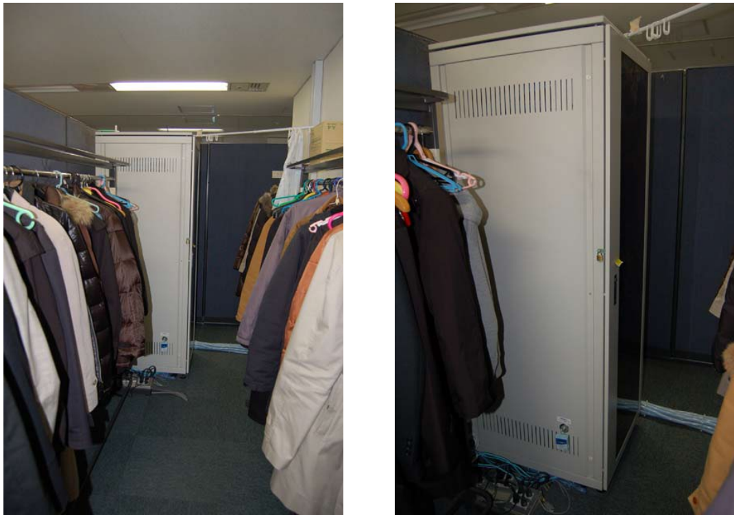
図 4.1-2 ラック B (北側フロア内に設置)と周辺の風景
