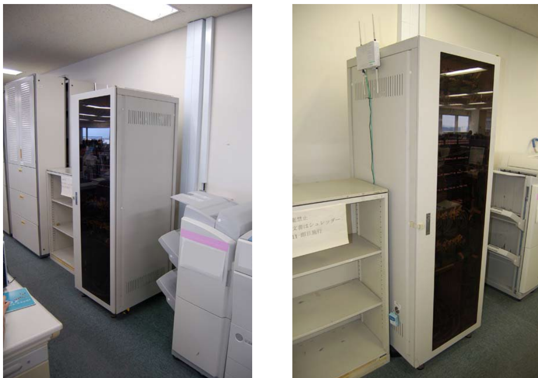
図 4.1-1 ラック A (南側フロア内に設置)と周辺の風景
