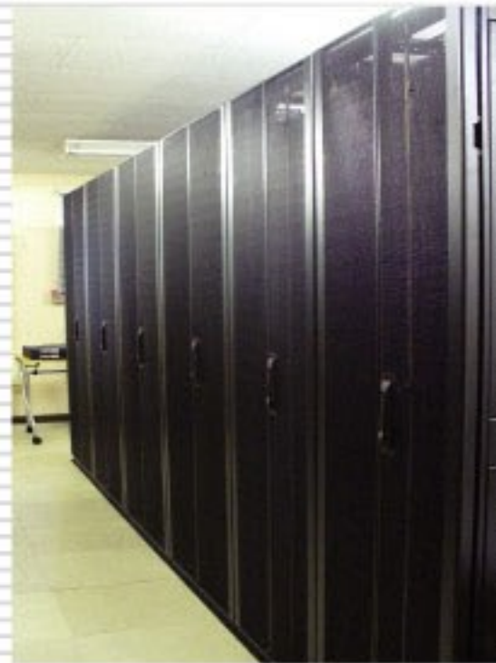
■サーバールーム HINET2007はセキュアなキャンパスネットワークを支えている
